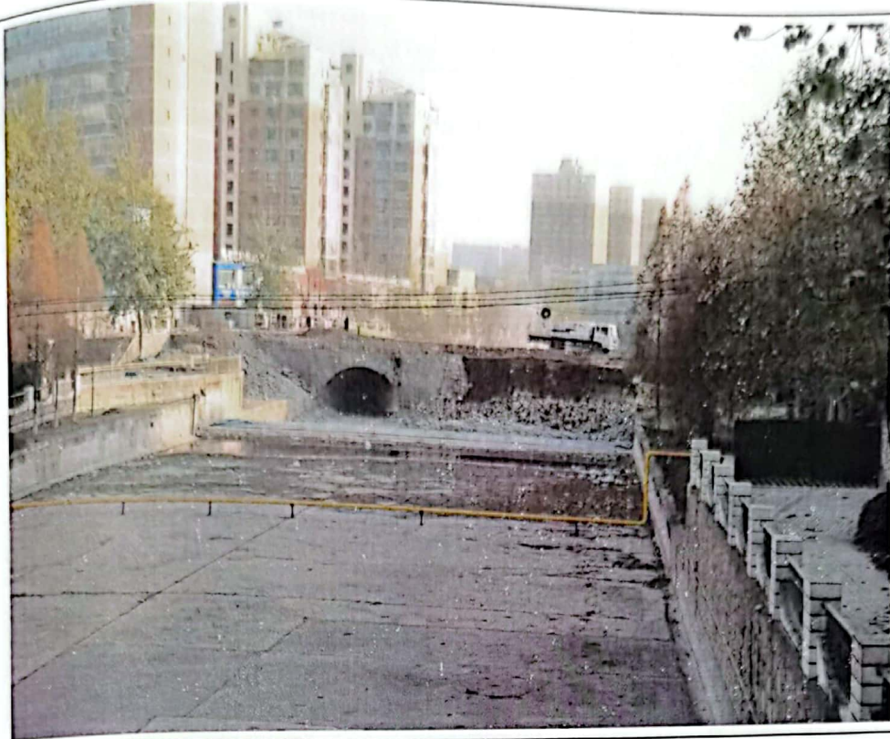
群英河桥河道部分未采取拦挡防护措施
